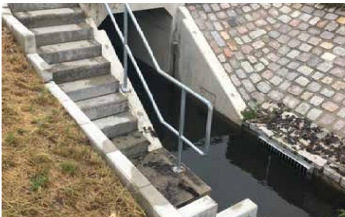
Bewährungsprobe bestanden: Der neue Durchlass Eichenallee konnte die Wassermassen Ende Juni sehr gut ableiten. Das Vorgängerbauwerk wurde 2017 zum Hindernis. Die Gemeinde investierte daraufhin ca. 700 000 Euro für den größeren Durchlass.
