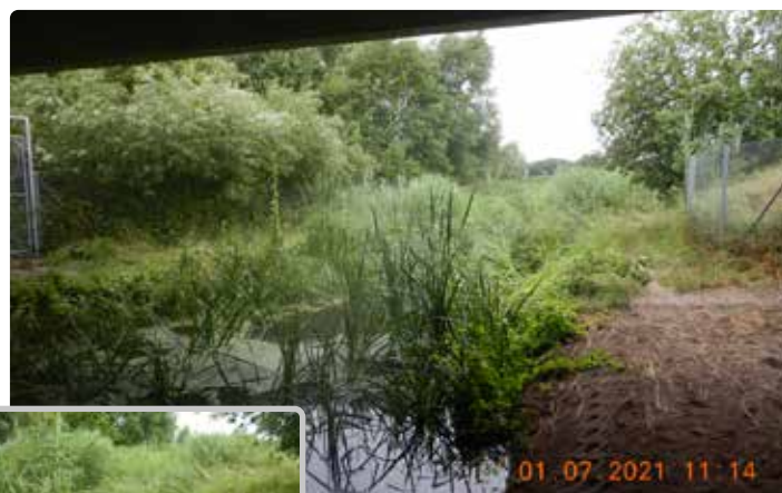
Verkräuteter Abfluss des Pinnower Nordostgrabens unter der B96neu und in der Gemarkung Hohen Neuendorf (kleines Bild)
