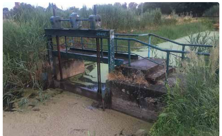
Verschlussenes Wehr in Velten. Nicht immer muss ein Wehr offen sein. Manchmal hilft ein geschlossener Abfluss, das Wasser aus Leegebruch schneller abzuleiten, da ein Gegendruck verhindert wird.
